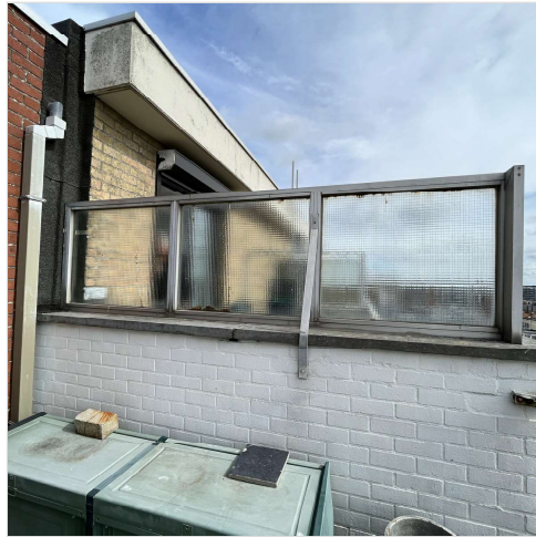
gebarsten draadglas achtergevel app 1002
