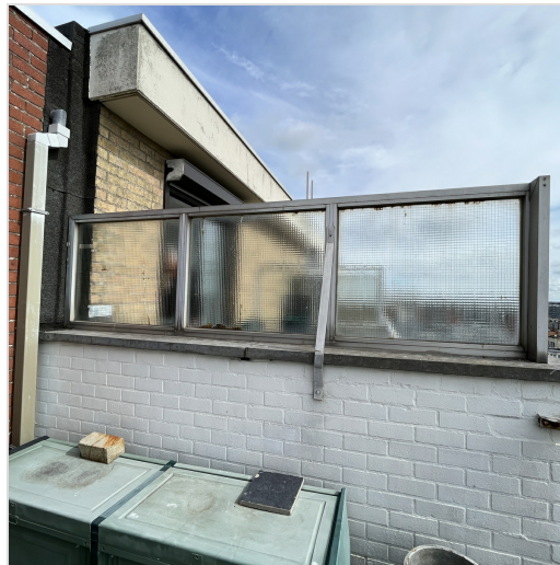
gebarsten draadglas achtergevel app 1002
