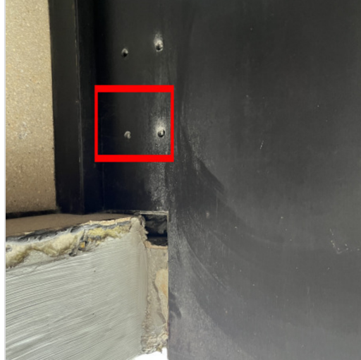
aansluitpunt wachtbuis fiber
