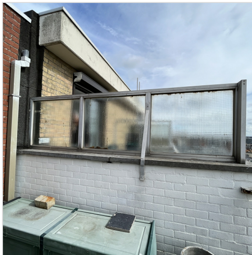
gebarsten draadglas achtergevel app 1002
